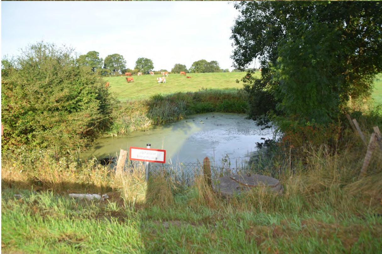
Feuerlöschteich Steinwehr, Richtung Rade: Zaun defekt, ausreichende Wasserführung: Der BUA empfiehlt die Reparatur/Erneuerung Zaun.
